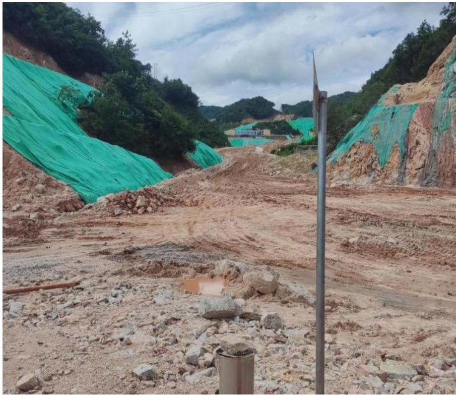
照片3 矿山道路破坏地形地貌景观
