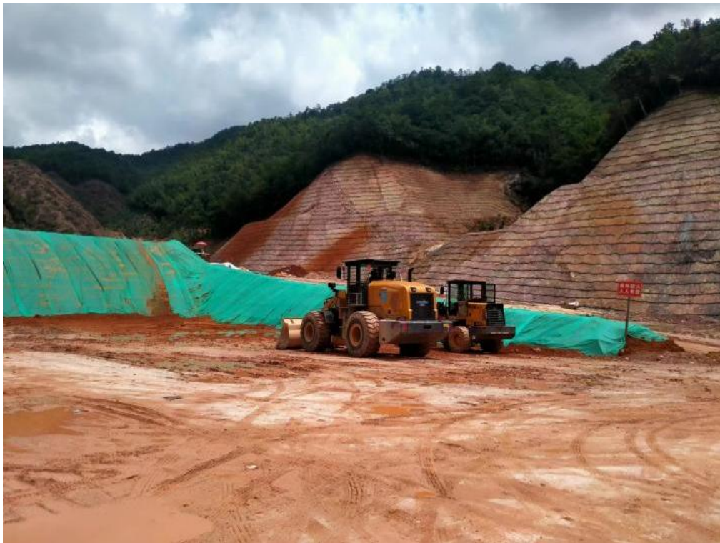
照片24边坡复绿区1修复前
