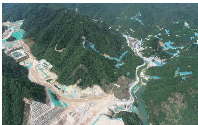
照片4-1 选矿工业场地破坏地形地貌景观
